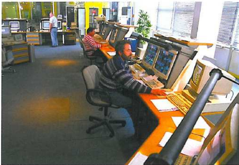
Usine de Méry : le poste de commande
