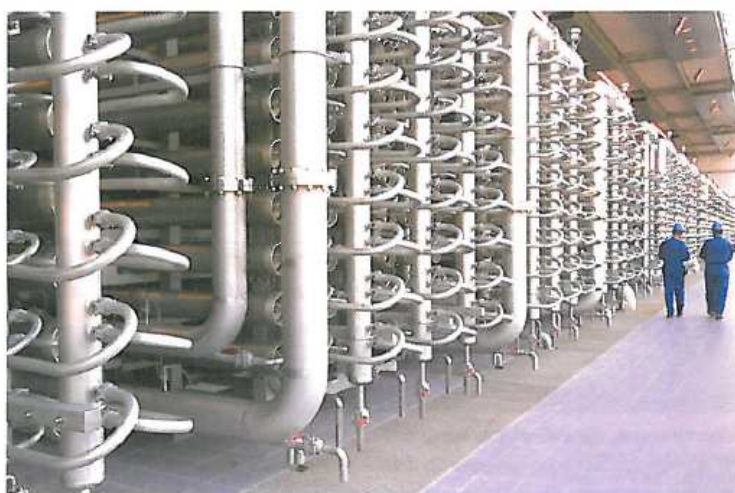
Usine de Méry - Salle de nanofiltration
